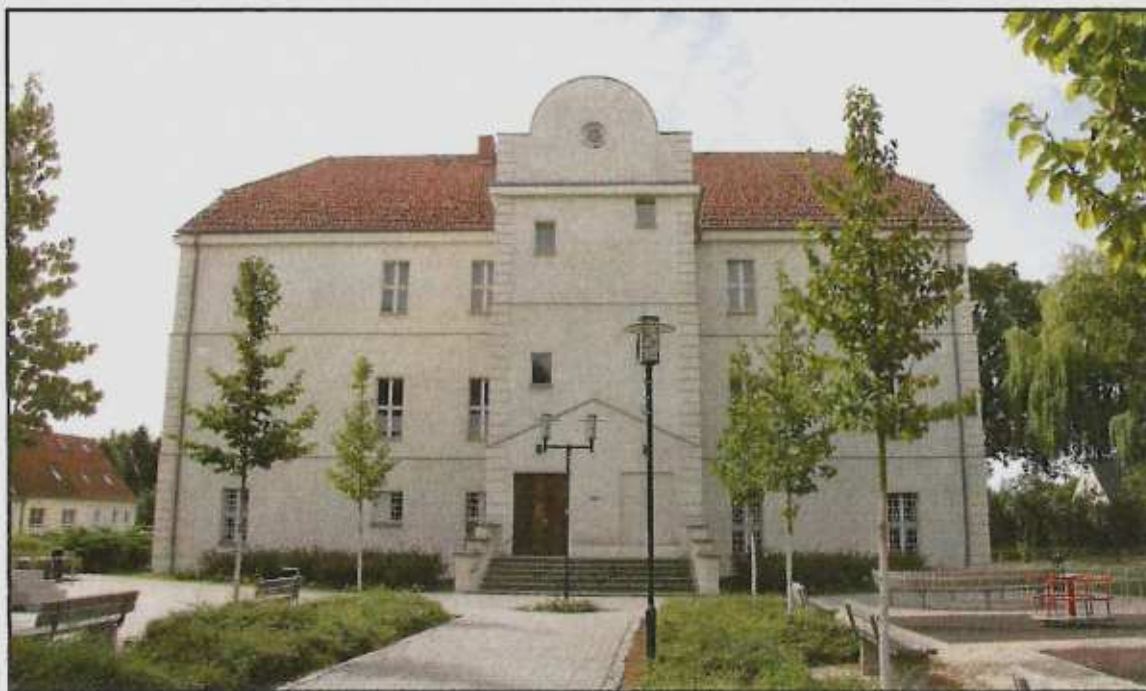
Abb. 8: Die Hüllensanierung des „Schlosses“ erfolgte von 2009 bis 2011 in zwei Bauabschnitten. Foto: D. BESTER, 2015
